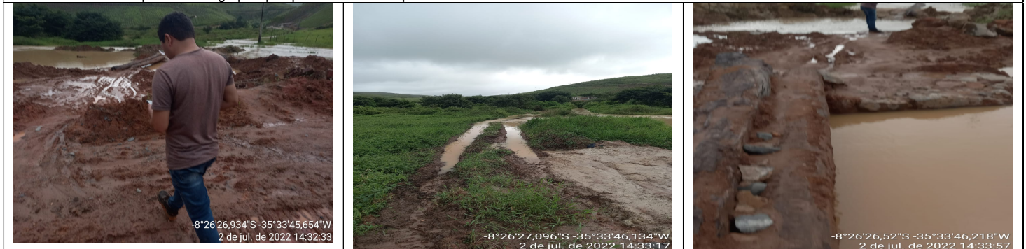
Estradas Vicinais inaptas ao tráfego por qualquer meio de transporte. Ocorrência de deslizamentos de Talude. Ponte de Barra do Sangue destruída
