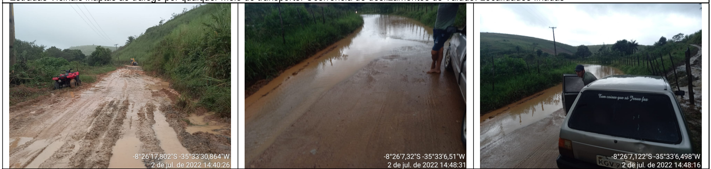
Estradas Vicinais inaptas ao tráfego por qualquer meio de transporte. Ocorrência de deslizamentos de Talude. Localidades Ilhadas
